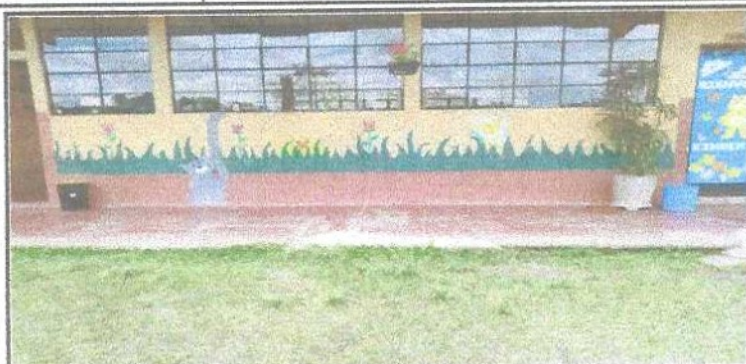
Foto 1: FOTOGRAFIA CONCRETO A MEJORAR
